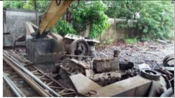
Foto 22. Restos metálicos desechados.
